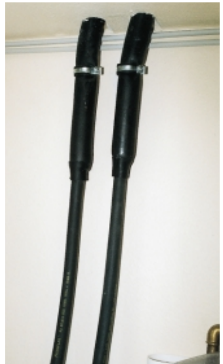
Mehr ist zwischen Ober- und Untergeschoß nicht zu sehen. Armaflex-isolierte Vor- und Rücklaufleitung für die Fußbodenheizung-Direktkondensation mit dem Kältemittel R 407C
